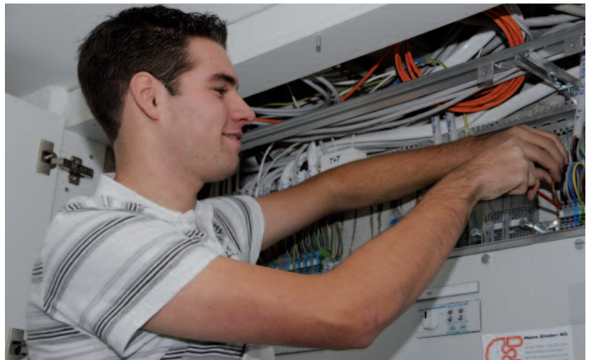
Sascha Wehrli bei der Arbeit an einem Elektrotabelleau.
