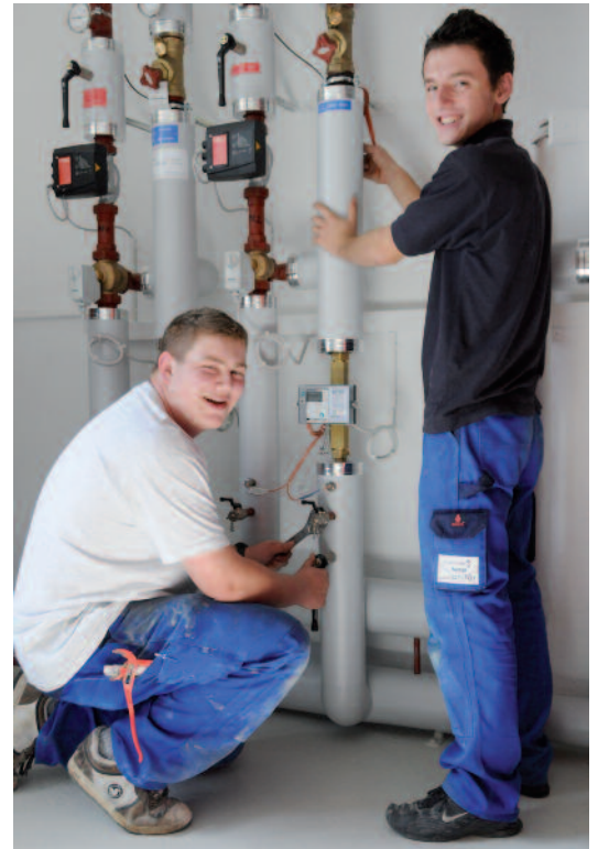
Pascal Bussien (links) und Behar Nuredini vor einer Technikanlage, bei der sie mitgearbeitet haben.
